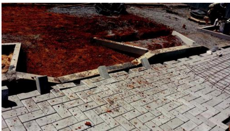
Figura 20 - Acessibilidade: Execução de rebaixo de calçada para vaga reservada (CCEI) Fonte: NENG
